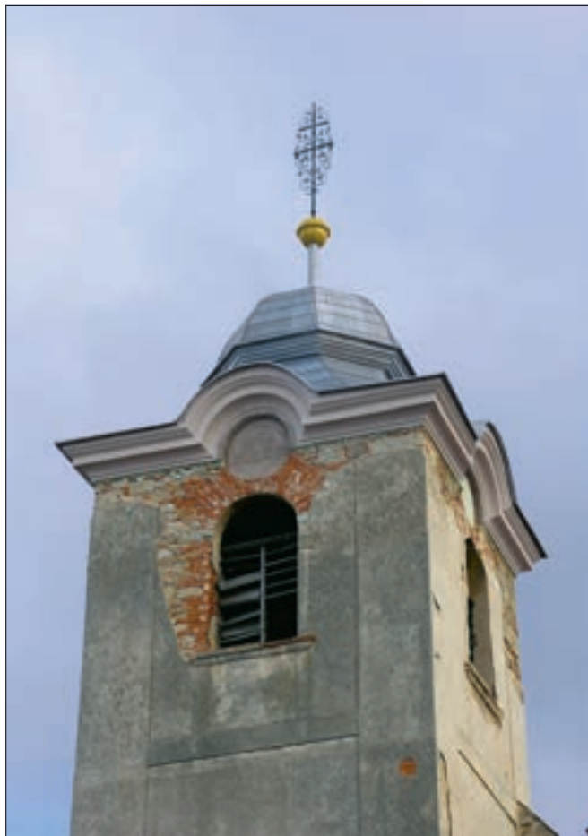
Veclov (okres Rakovník), kostel Věch svatých. Horní část západní věže kostela po dokončené opravě, provedené ve velmi dobré kvalitě. Stavebně-technický stav kostela se nadále zhoršuje, a to jak v exteriéru, tak uvnitř stavby. V pokročilém bavorském stavu byla zejména horní část západní věže. Podílely se na něm zejména dožilá zrezavělá plechová krytina, nakloněná brotnice s ozdobným křížem, dlouhodobě opadané fasádní omítky s obnaženým postupně se drolicím zdivem ztrácejícím soudržnost. Jelikož těsně kolem stavby prochází frekventovaná místní komunikace, hrozilo nebezpečí vážného úrazu. Proto bylo nutné neprodleně začít s opravou střechy věže s korunní římsou, stav v červnu 2015 (foto E. Volfová).
