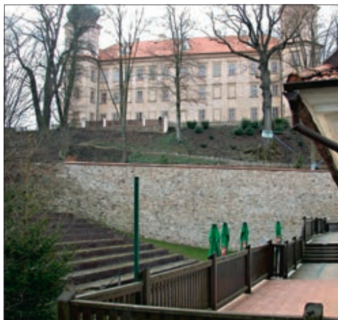
Mníšek pod Brdy (okres Praha-západ), zámek. Pohled na východní partii zámeckého areálu po obnově úseku obřadní a opěrné zdi, původní konstrukce se zřítíla v květnu 2013 do prostoru amfiteátru u bývalého pivovaru. Šlo o úsek dlouhý cca 30 m a v proměnlivé výšce 5–8 m, původně z prosté zděné konstrukce ze smíšeného zdiva, založené v roce 1656 a později postupně zvyšované, stav po obnově (foto E. Zápalková).
